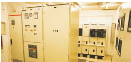
PLC locais controlam, monitoram e enviam para a Internet dados operacionais de todos os equipamentos da planta de cogeração
