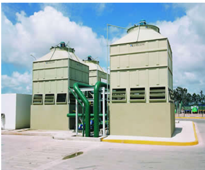
As torres de refrigeração rejeitam o calor do sistema de pós-arrefecimento de ar dos grupos geradores CAT e a carga térmica através dos chillers de absorção e centrífugo
