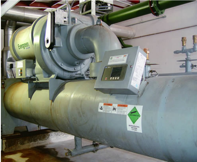
Para atender a demanda térmica total do aeroporto, a central de cogeração conta ainda com uma unidade centrífuga de 500 TR
