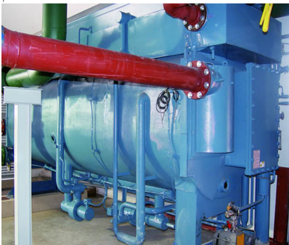
O chiller de absorção utiliza água quente fornecida pelo conjunto gerador CAT para a climatização do aeroporto
