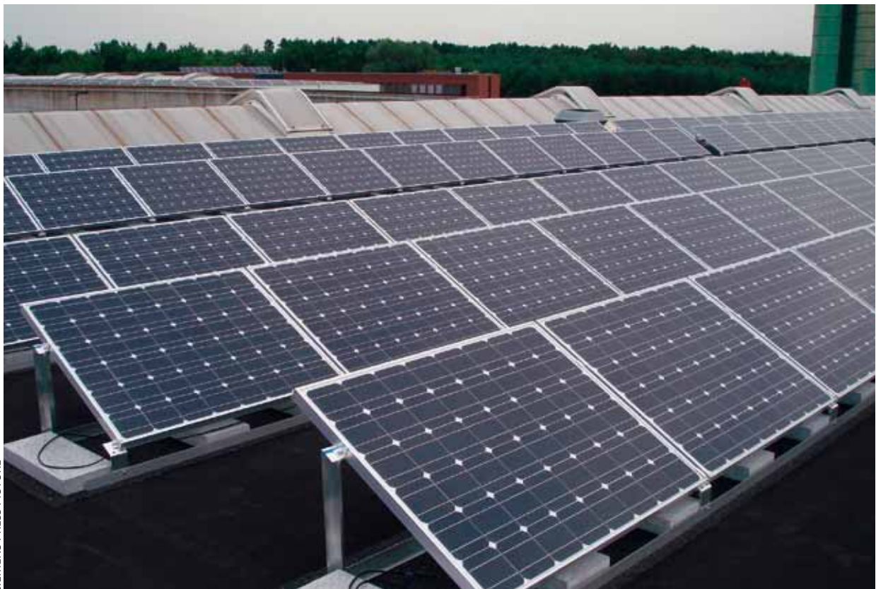
Painéis solares fotovoltaicos.
