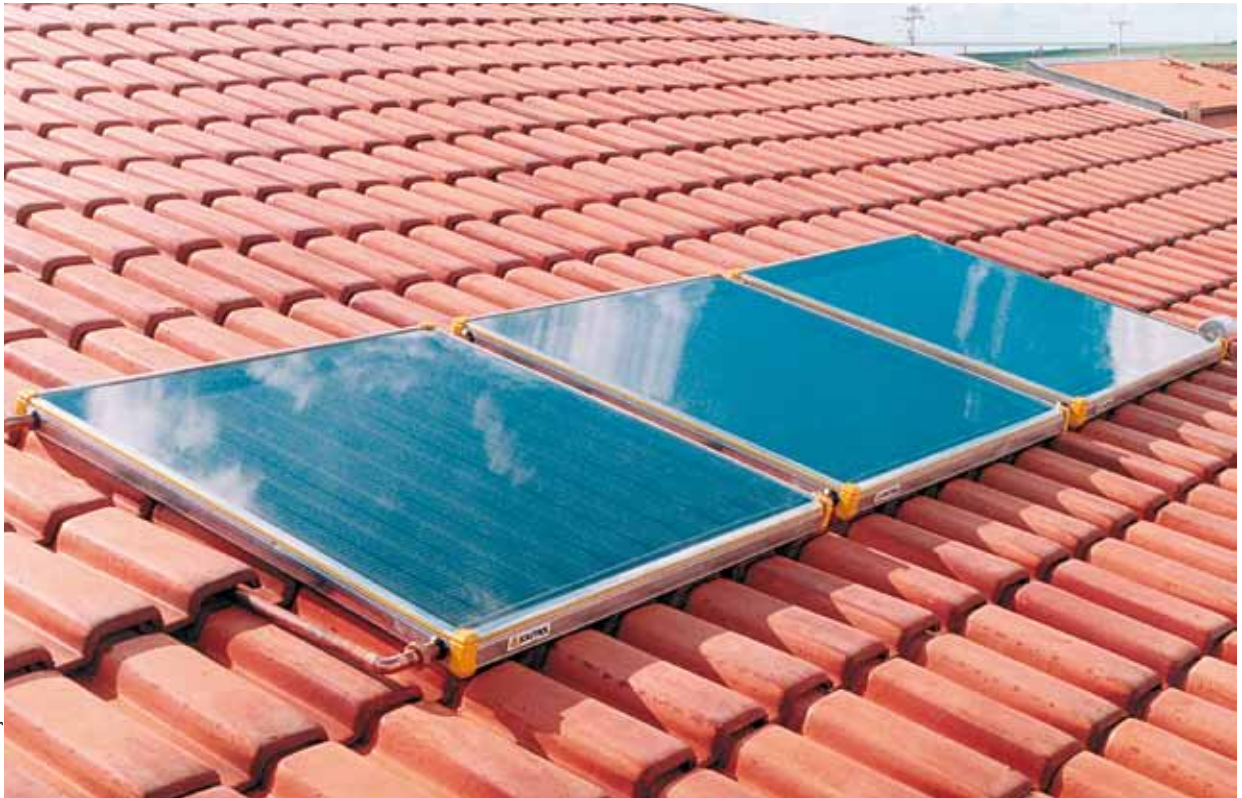
Painéis de aquecimento solar: a instalação de 300.000 m 2 desses painéis geraria economia de 122 MW.
